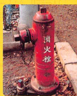
地上式消火栓
