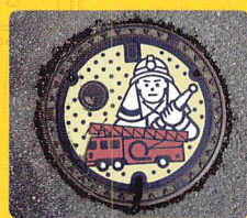
地下式消火栓
